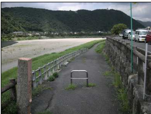
写真 2-33 防護柵と車止め
