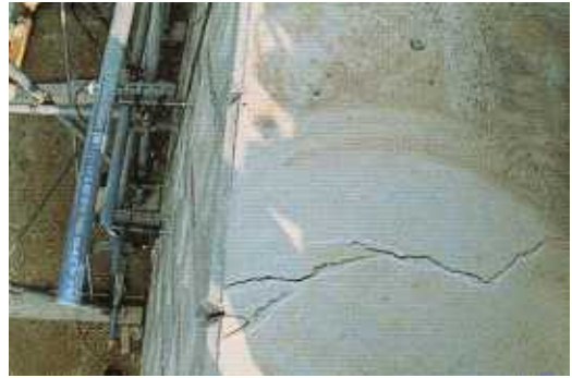
すぐにクラックの入ったコンクリート よう壁
