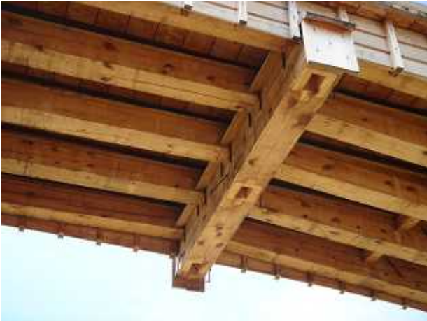
橋杭が綺麗に外れ、損傷が少ない
