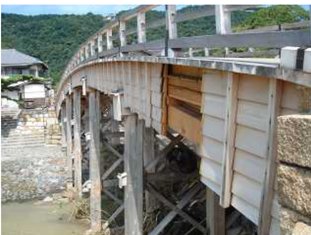
第五橋下流側の部板が一部流失しました
