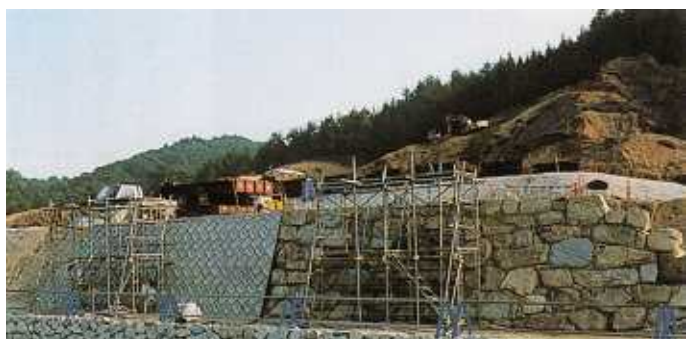
第 2 名神高速道路甲南トンネル（滋賀県）のよう壁として穴太衆積を採用する際に、その安全性を立証するための実験が大々的に行われた
