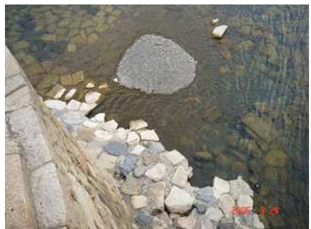
第三橋脚下流の敷石の剥離が判明しました
