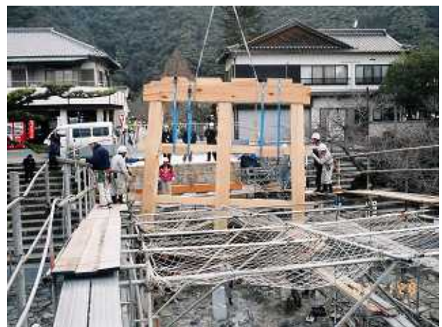
平成の架替では、あらかじめ組んだ橋杭をクレーンで吊り下げて据え付けた
